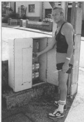
Une commande de point lumineux
