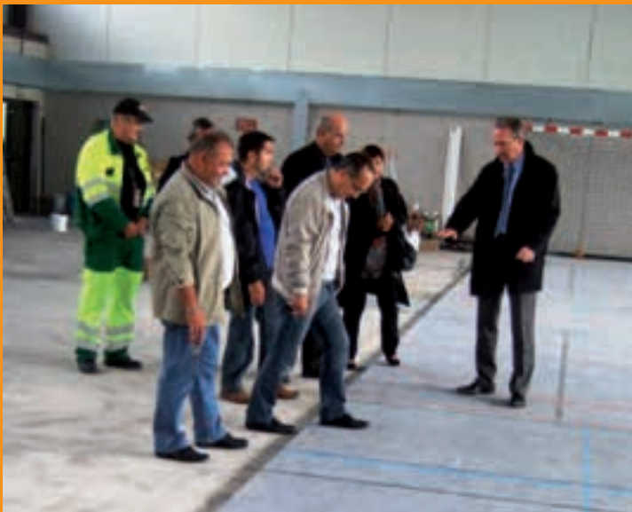
Visite du chantier après le sinistre dégât des eaux
