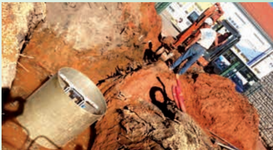
La pompe de relevage est enterrée à 3,50 m de profondeur à l'entrée du complexe sportif, face à l'école des Genêts
